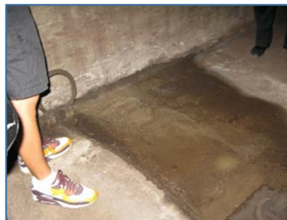
道床裂缝及渗漏
