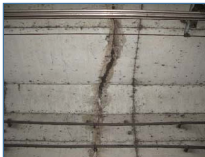
环向贯穿裂缝
